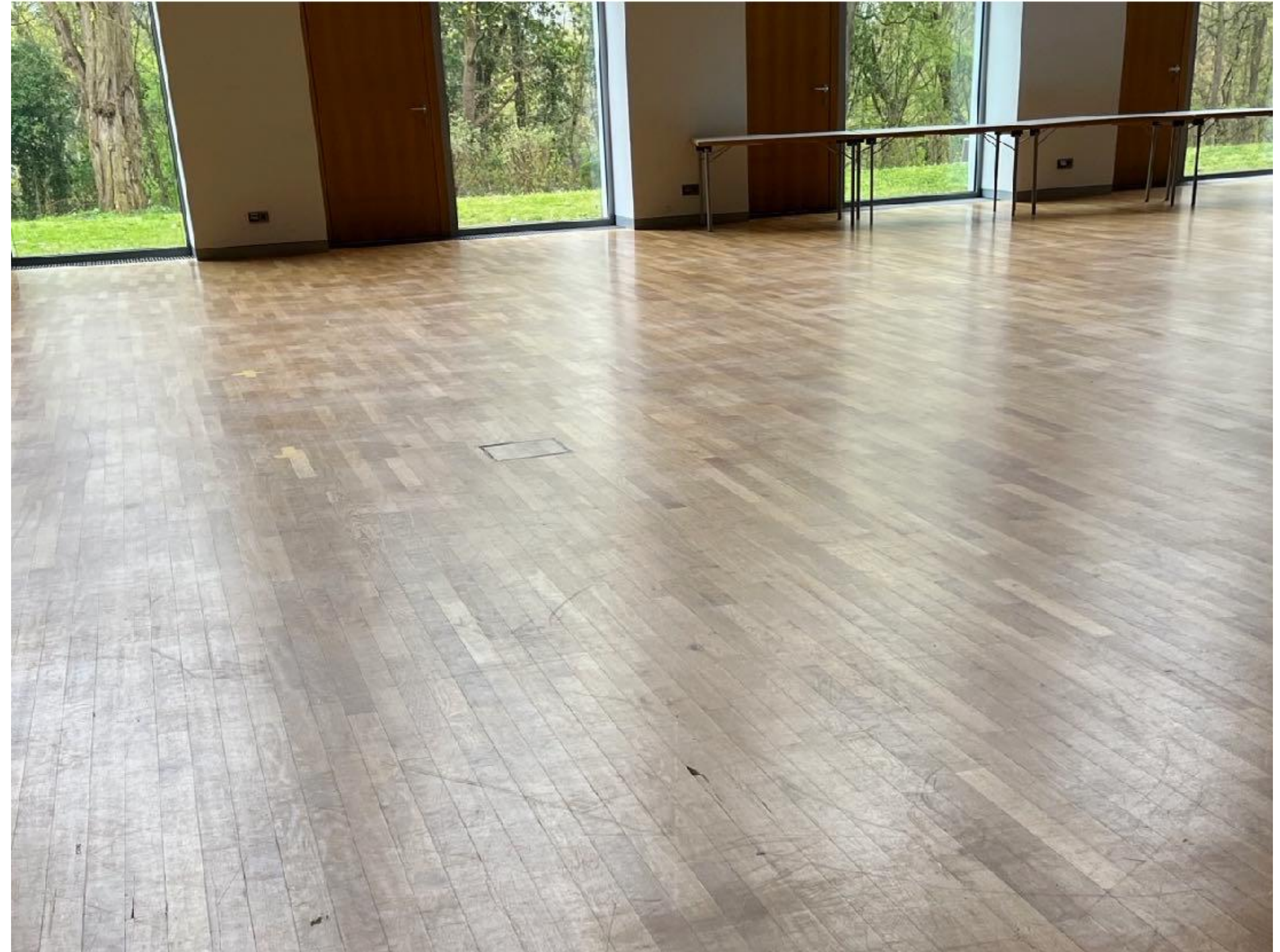
Stabparkett vor Reinigungs- und Pflegemaßnahme.
